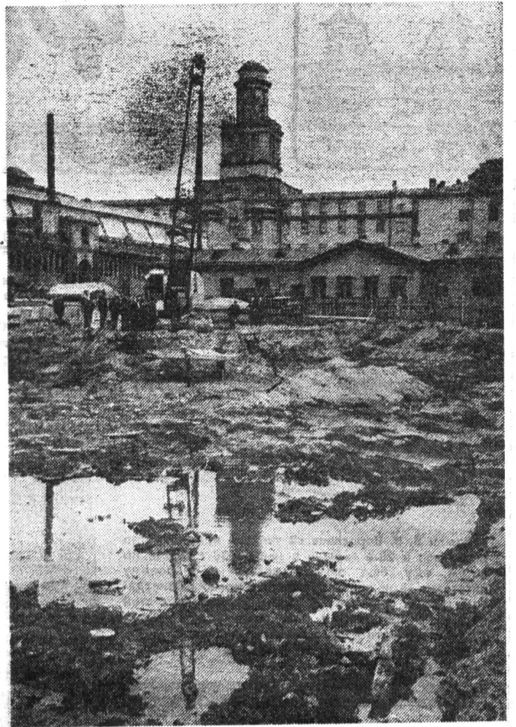
Закладка фундамента нового корпуса на Саблинской улице. Начальства, как у нас водится, гораздо больше чем исполнителей. 1970 год.
